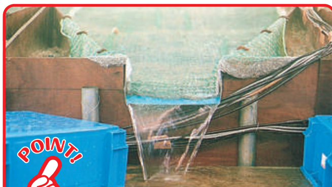
POINT! 多機能フィルター 侵食を防止しているため濁水が発生していない
